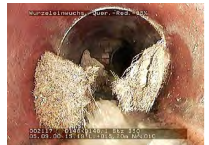
Abbildung 31: Ergebnisse einer Zustandsprüfung: Undichte Bestandsleitung mit eindringendem Grundwasser (oben); Wurzeleinwuchs (unten). (© GEB)
